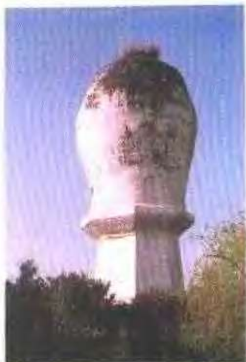
云南楚雄大姚白塔 (邓启耀摄)
